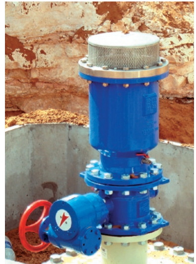
Zabudowa zaworu napowietrzająco-odpowietrzającego Hawle na instalacji
